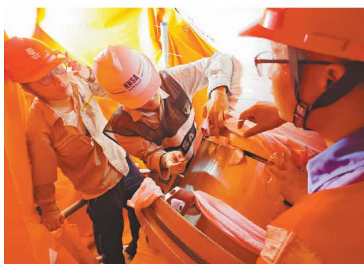
图为华东监督站监督员在海阳核电厂3号机组开展主管道焊接检查。
