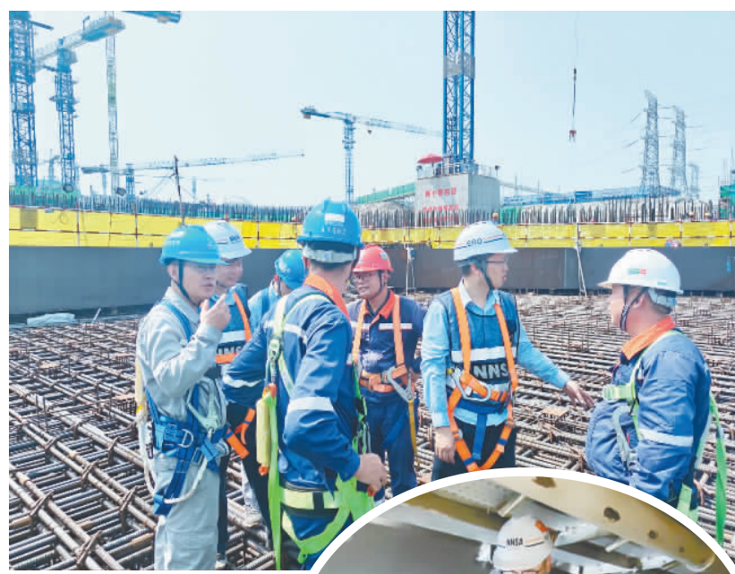
▲图为华东监督站监督员在漳州核电开展核岛钢筋绑扎检查。
